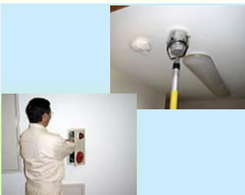
■消防設備点検
