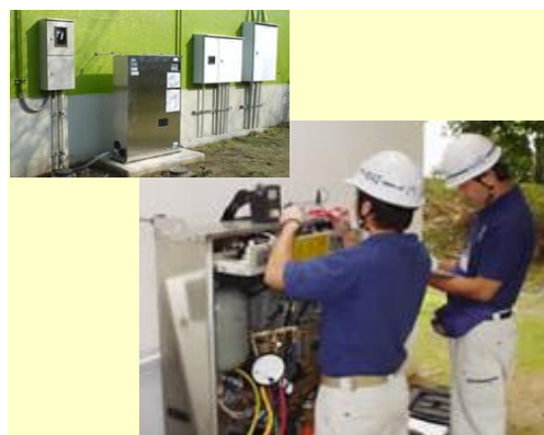
■給水ポンプ点検
