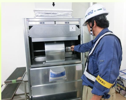
■空調設備点検
