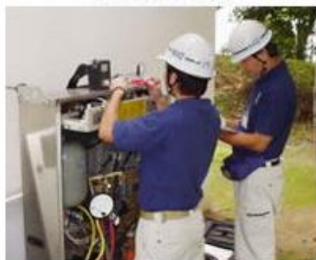
〈ブースターポンプ点検〉
